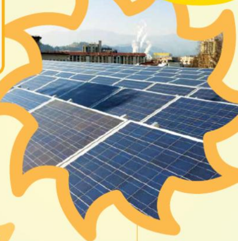
Sončna elektrarna na strehi.
